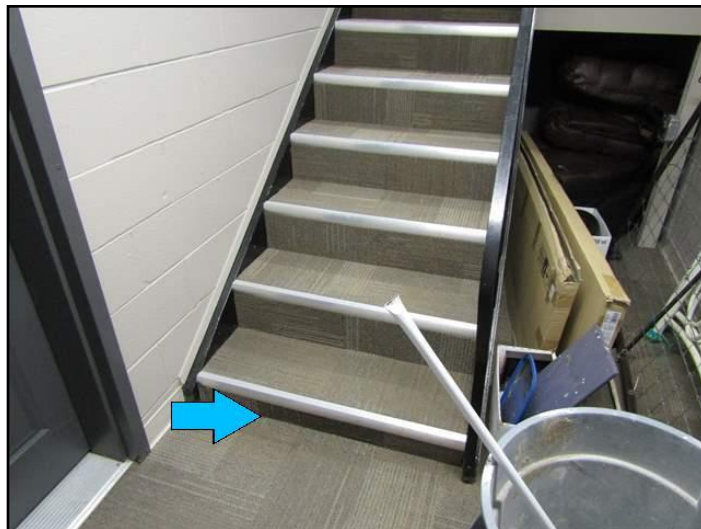
Uneven riser heights
